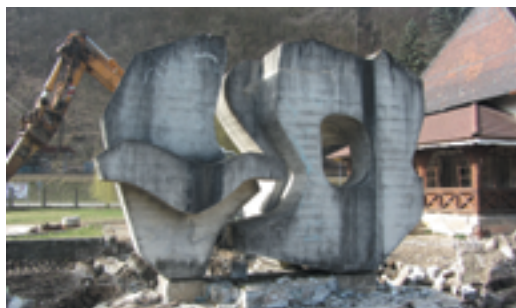
Památník Dělnického domu - postavený v r. 1971, zlikvidovaný v březnu 2014
